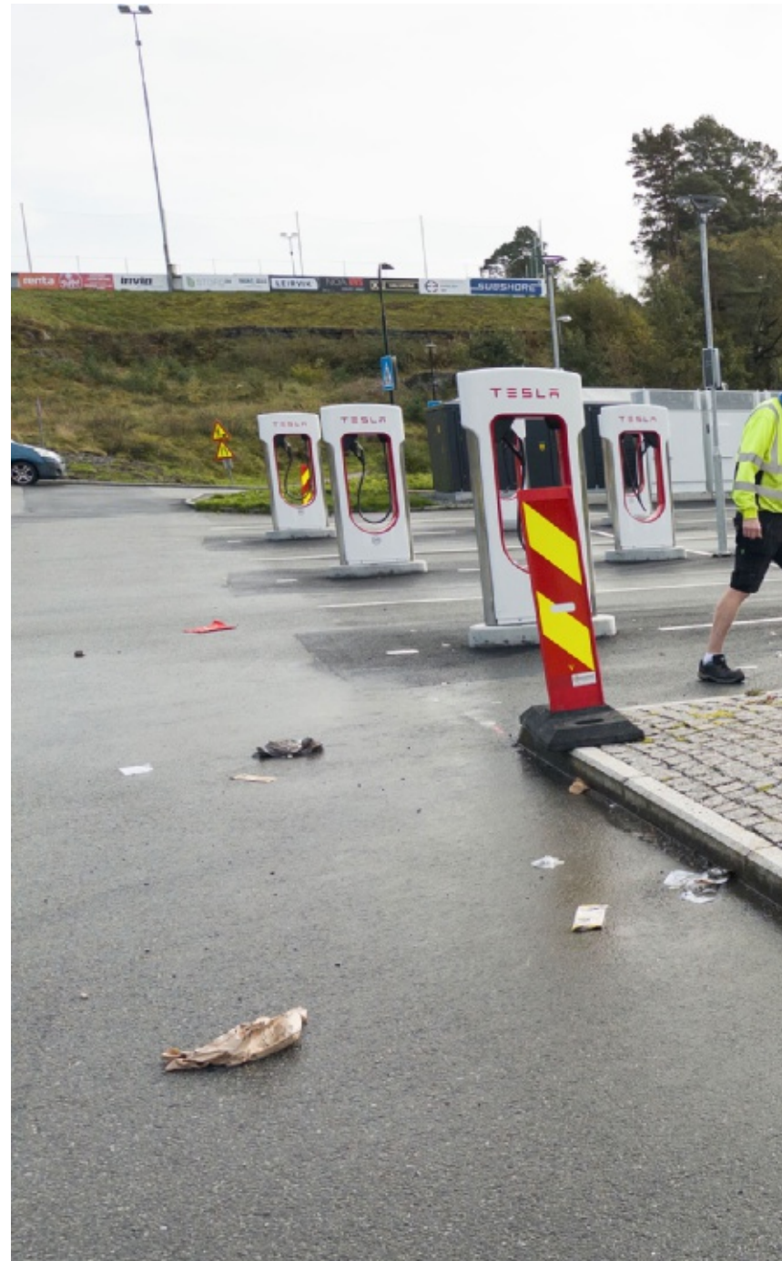
Den nye Tesla-ladestasjonen på Vabakkjen har vore i drift sidan september.
