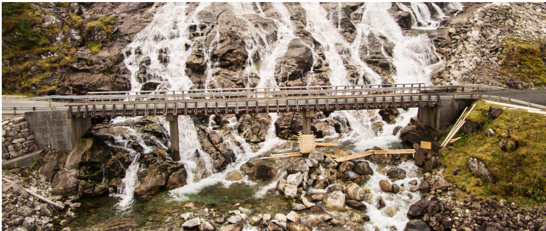
UTSATT: Furubergfossen bro, en smal bro med tredekke, er en av mange broer i Hordaland som Vegvesenet ikke har inspisert slik de skal. Foto: JØRGEN BRAASTAD
