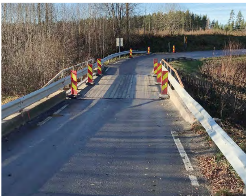
ETTER: Melland bro etter at VG gjorde oppmerksom på at det manglet innsnevring. Foto: STATENS VEGVESEN
