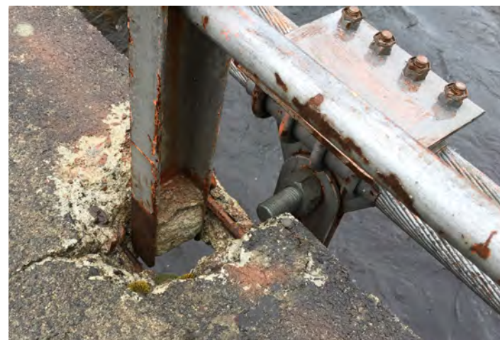
HULL: Rognes bro i Sør-Trøndelag. Hull i betongen der rekkverket skulle vært holdt på plass. – Det er ikke funnet rom for å prioritere tiltak på broen til nå, sier seniorrådgiver Håvard Austvik i Statens vegvesen region midt. Foto: ØYVIND ENGAN
