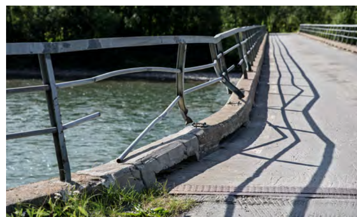
LØST: Langvad bro i Nordland. Tre rekkverksstolper på rad er ødelagt, slik at det i praksis ikke er noe som holder rekkverket på plass i dette hjørnet. – Denne broen står på en lavtrafikkert vei. Den er på prioriteringslista for tiltak, men har ikke nådd opp for tildeling av midler. Den planlegges utbedret til neste år, sier avdelingsdirektør Marianne Eilertsen i Statens vegvesen region nord. Foto: JØRGEN BRAASTAD
