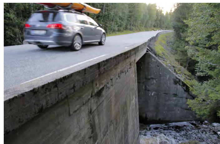
HØYT NED: Stavå bro i Telemark. 6 meters fall ned til en steinete bekk, rekkverket er 30 cm høyt. – Dette er i prinsippet ikke en skade/feil/mangel. Da broen ble bygget i 1956, var dette en akseptabel rekkverksstandard på broen, sier Knut Asbjørn Koland, seksjonssjef for brovedlikehold i Statens vegvesen region sør. Foto: ØYVIND ENGAN
