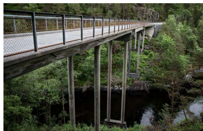
NETTINGGJERDE: Økstrafjord bro i Rogaland. – Det er godt mulig at rekkverket skulle vært utbedret, men vi har så langt prioritert broene som har 16- og 12-skader, sier avdelingsdirektør Astrid Eide i Statens vegvesen i Rogaland. 16 og 12 er de to alvorligste nivåene i Vegvesenets system Brutus. Rekkverket på Økstrafjord har fått karakteren 9 på denne skalaen. Foto: JØRGEN BRAASTAD
