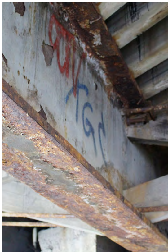
KRITISKE SKADER: Sluppenbrua inn til Trondheim sentrum har kritiske skader som truer bæreevnen, «med høyeste grad av konsekvens». Statens vegvesen håper å bygge ny bro sent i 2018.
