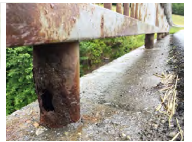
RUSTET: Skaden på brorekkverket ved Mølne Øvre i Sør-Trøndelag, er så stor at det må skiftes ut. Prioritering av utbedring må avklares med veieier, sier seniorrådgiver Håvard Austvik i Statens vegvesen region midt. Foto: ØYVIND ENGAN
