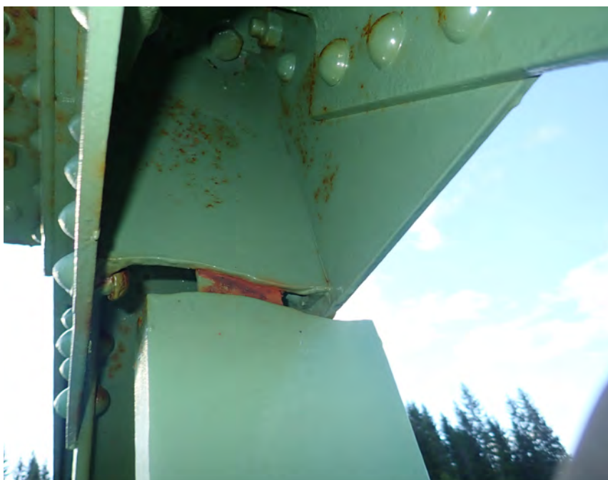
BRUDD: En metallbjelke på Fuglestad bro hadde røket tvers over. Foto: STATENS VEGVESEN
