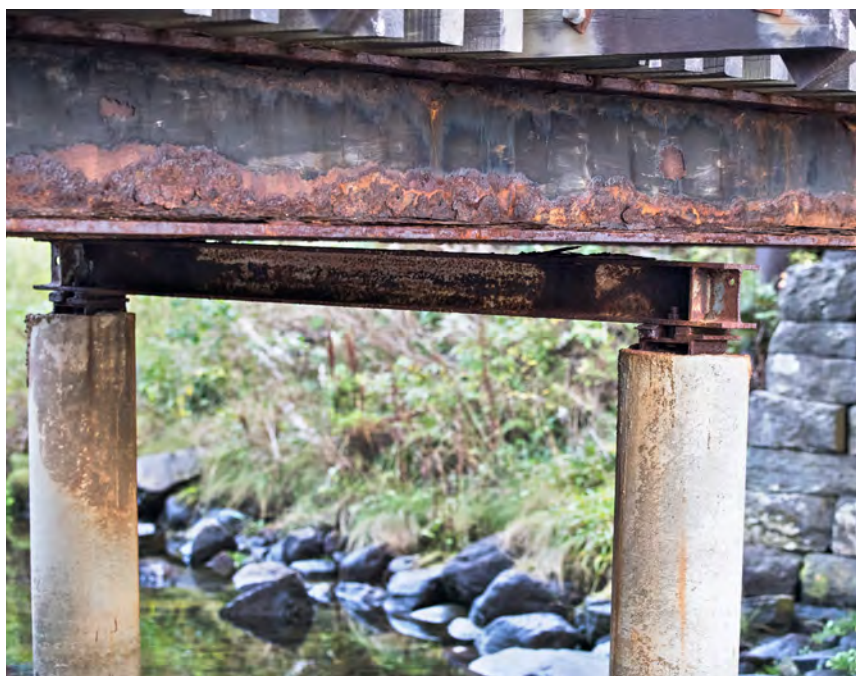
FØR: Synlig glippe mellom søyle og bærebjelke. Foto: HALLGEIR VÅGENES
