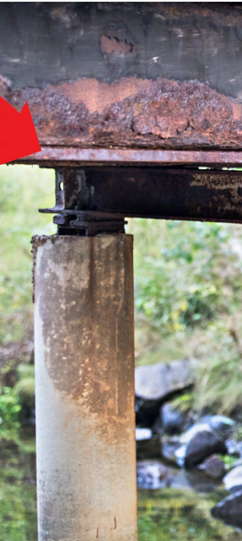
IKKE KONTAKT: En av søylene har sunket ned i elvebunnen slik at den rustne
